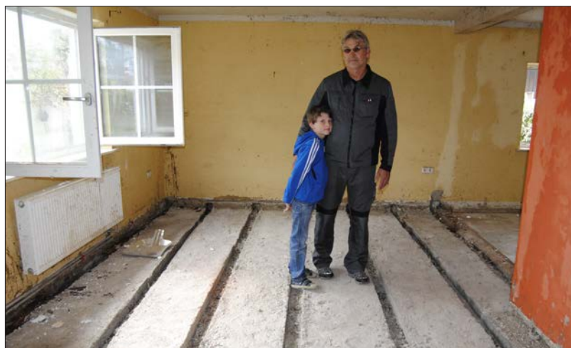
Beton statt Holzboden: Die Wassermassen haben alles zerstört.
