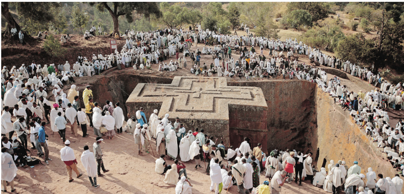
Des chrétiens orthodoxes en pèlerinage devant une des onze églises construites au XII e siècle, à Lalibela (Éthiopie). Ces édifices, qui ont été taillés directement dans la roche, présentent des fissures qui se multiplient avec le temps.
