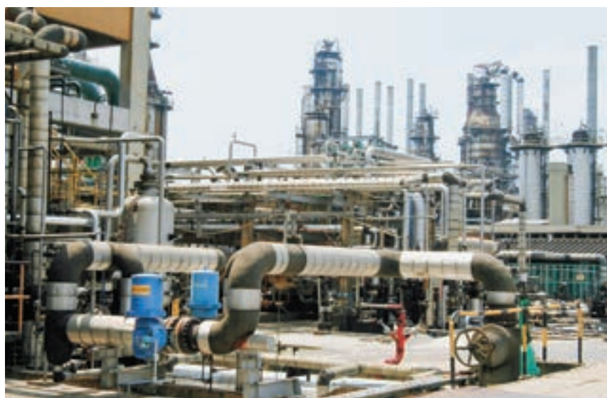
Planta com válvulas de controle de vapor da Refinaria Duque de Caxias (Reduc)
